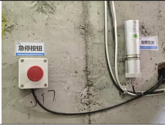
照片 10 检测室内紧急停机开关、固定式辐射报警装置探头
