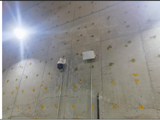
照片 11 检测室内摄像头、对讲装置
