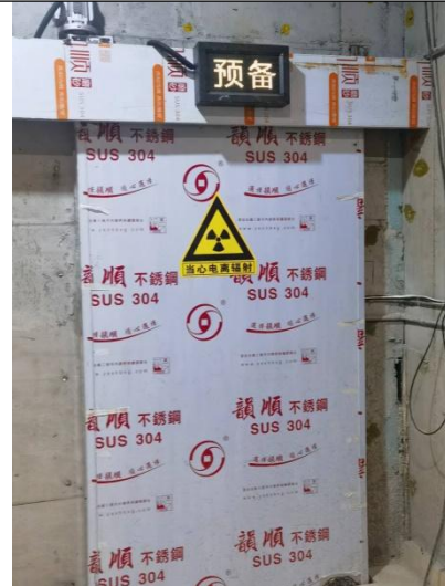
照片 7 人员门、电离警示标志、工作状态指示灯
