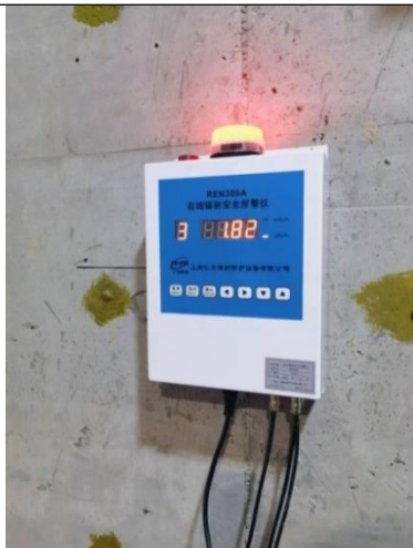
照片 19 固定式辐射报警装置显示屏
