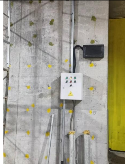
照片 13 检测室内工作状态指示灯
