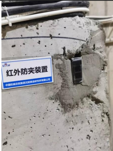
照片 16 人员门防夹装置
