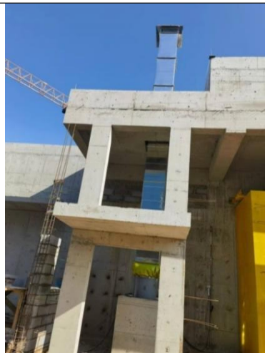
照片 20 通风外排口
