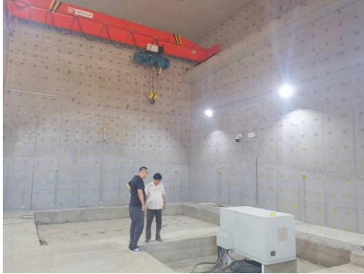
照片 4 加速器工业 CT 检测室
