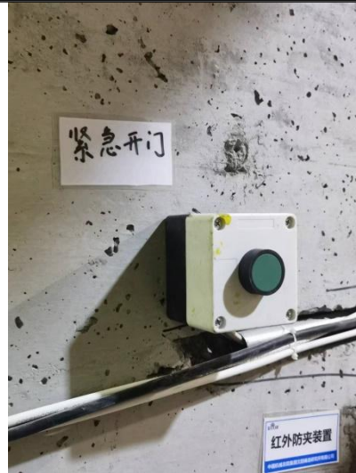
照片 17 人员门入口紧急开门开关
